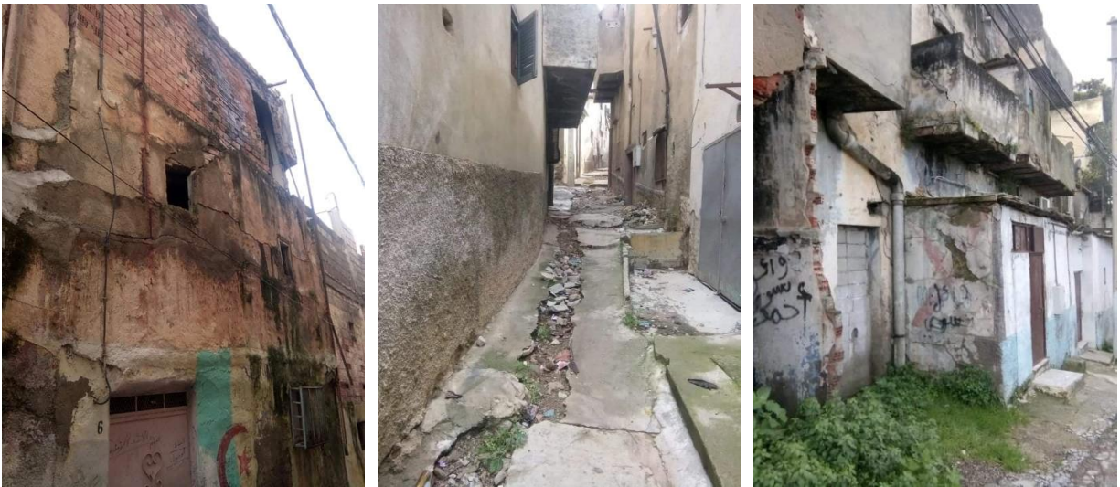
Figure 3.8 : Photos montrant la partie du quartier de la rue de Braham la plus touchée par le glissement de terrain
