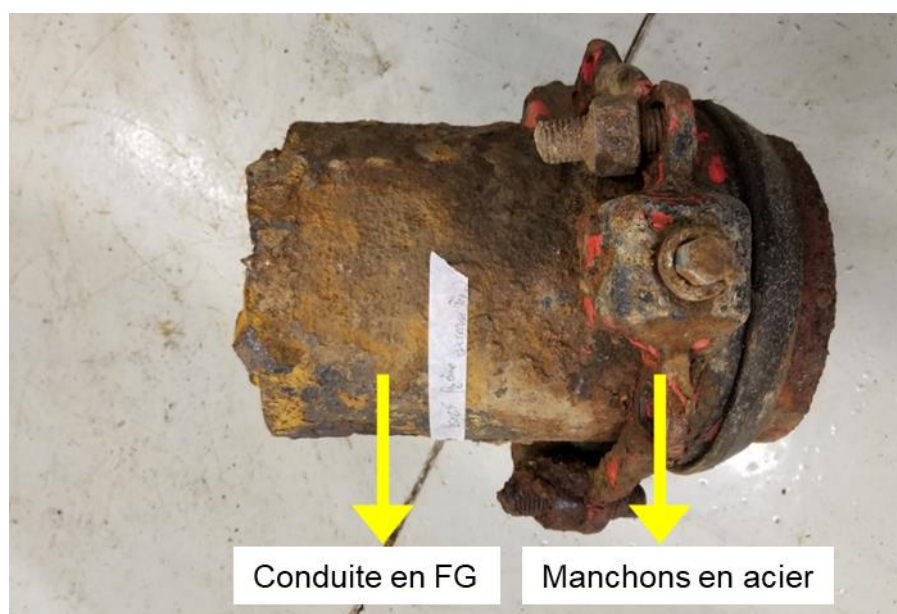
Figure 24 : Échantillon M-2 - Conduite en FG reliée à un composant en acier via un manchon en acier
