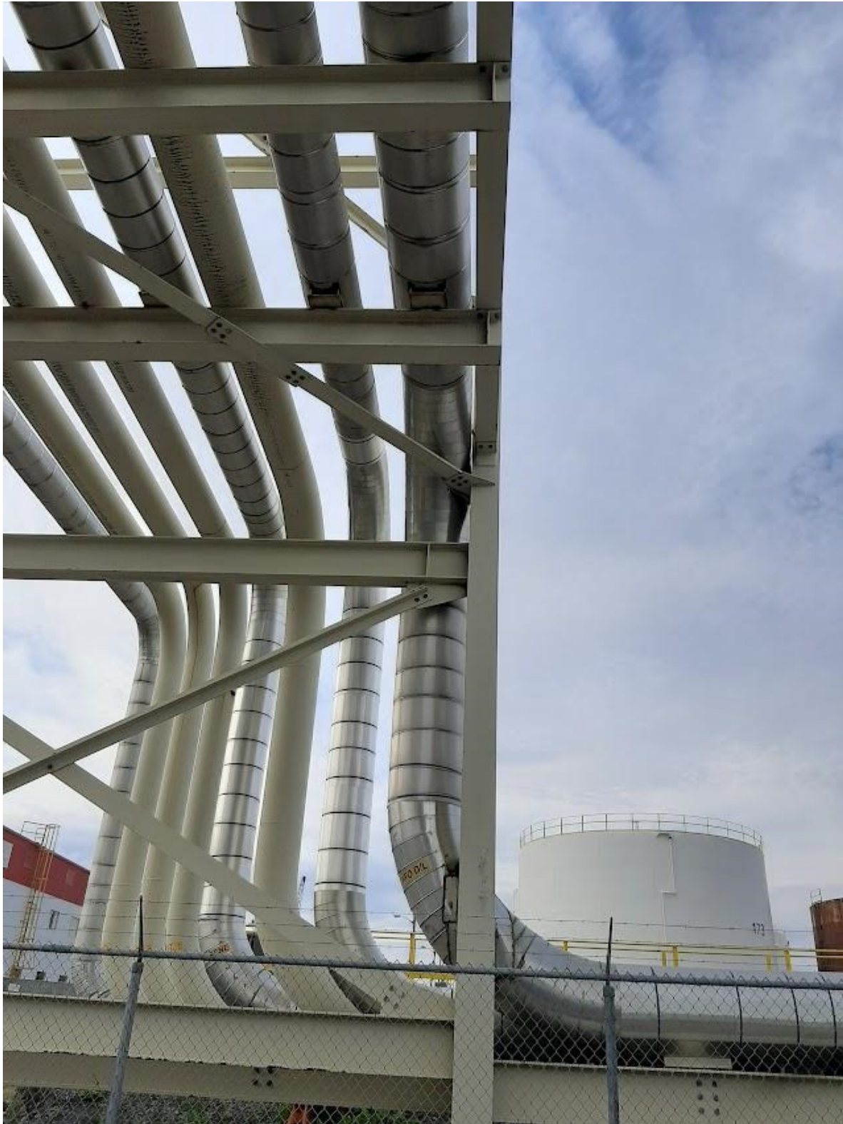
Figure 75 : Réseau de transport de produits pétroliers près de réservoirs à Montréal-Est Source : Hatton-Proulx 2022
