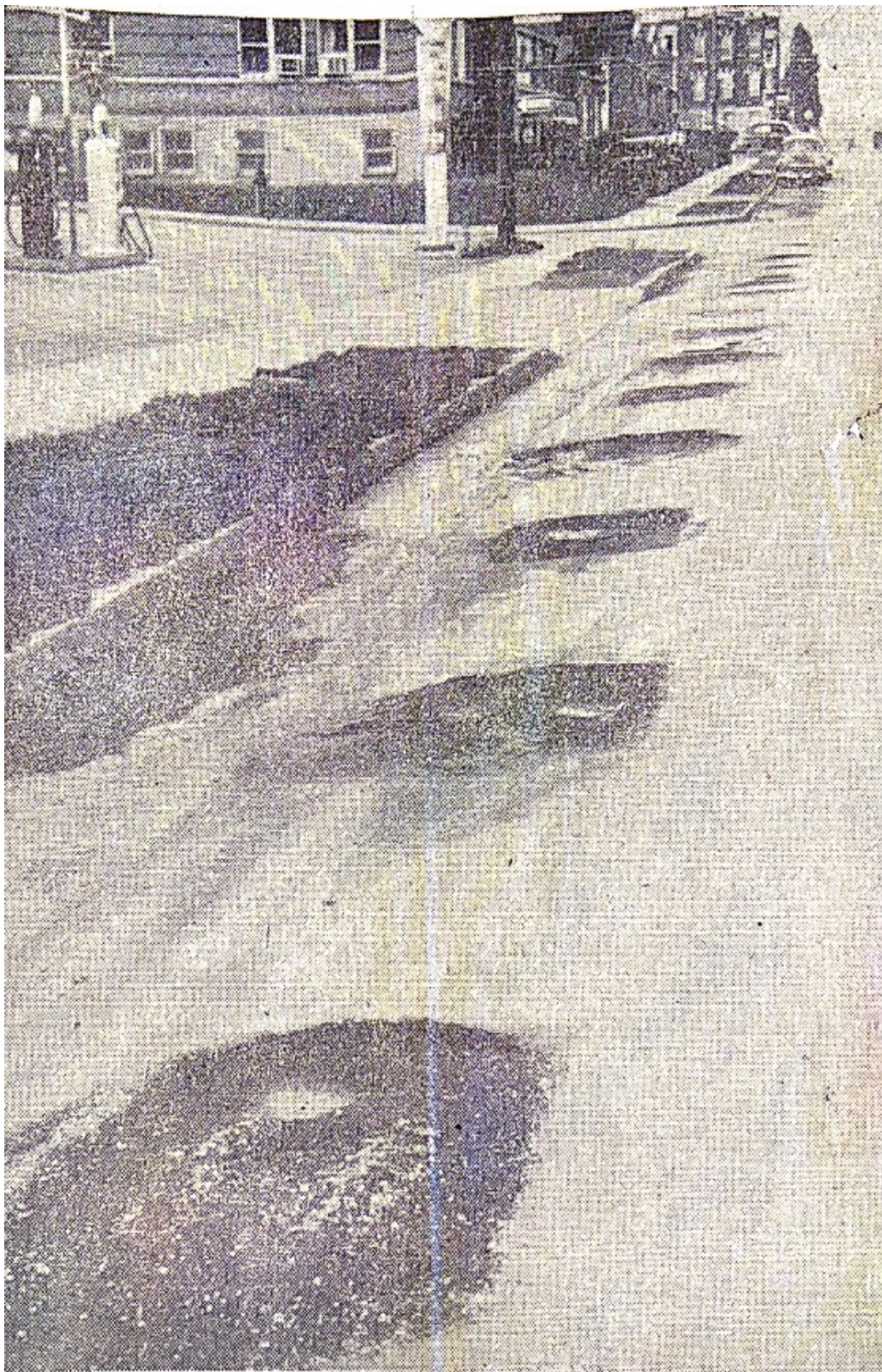
Figure 133 : Trous dans le pavage de la rue Hochelaga à cause des travaux effectués par la Corporation de gaz naturel du Québec
