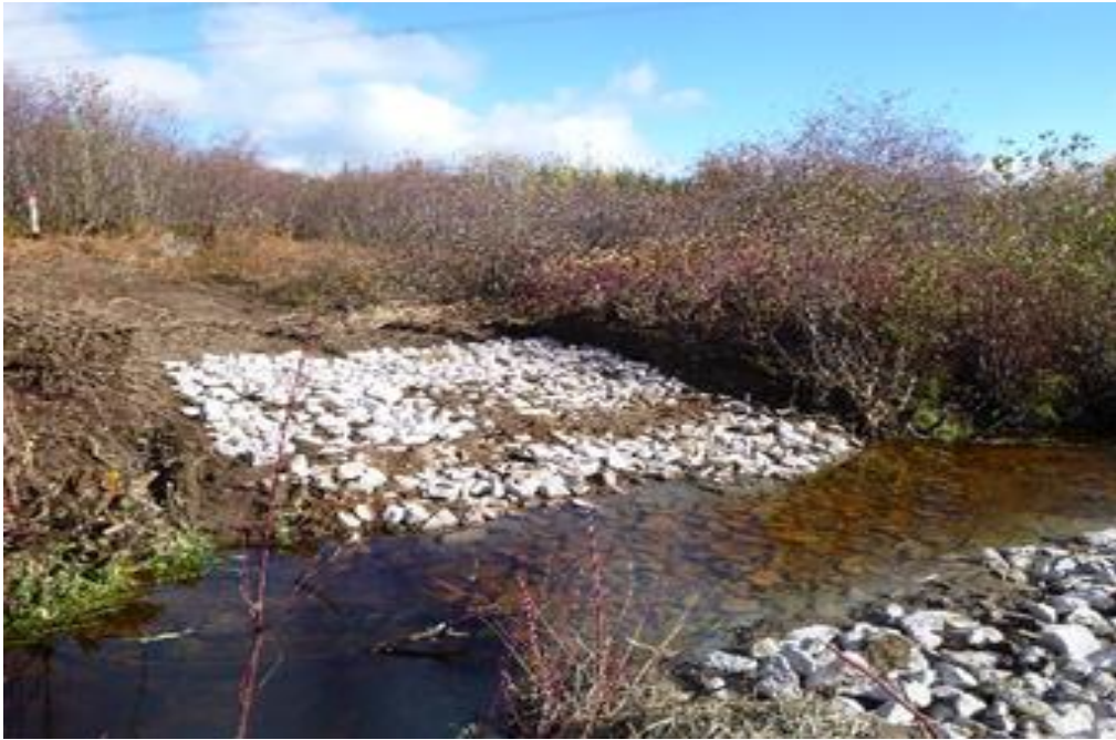
Figure 1. Traverse à gué aménagée et stabilisée avec de la pierre anguleuse © Kathy Pouliot (2019)
