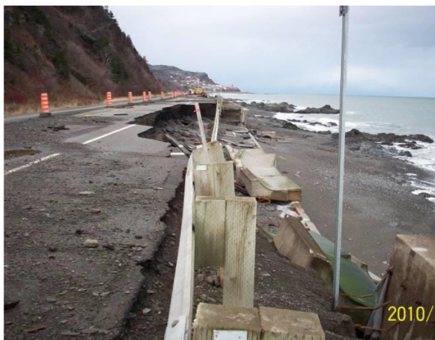
Figure 1.1 Exemples de dommages lors des tempêtes du a) 6 décembre 2010 (Quintin et al. , 2013)
