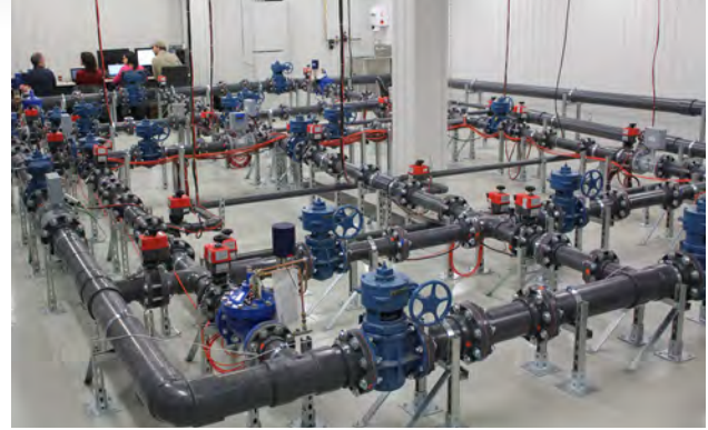
Réseau de distribution d'eau potable du laboratoire
