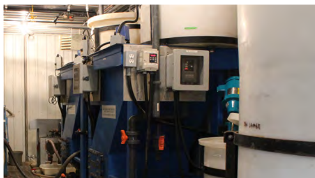
Décanteurs lamellaires avec instrumentation
