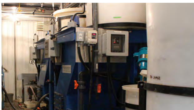
Décanteurs lamellaires avec instrumentation
