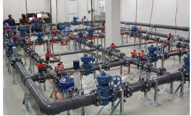
Réseau de distribution d'eau potable du laboratoire
