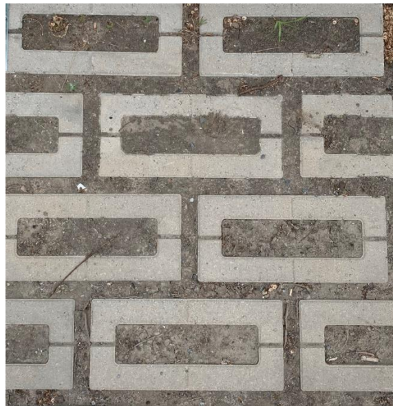
Figure 4.13 Pavage perméable au site #3 le 1 er juin 2021
