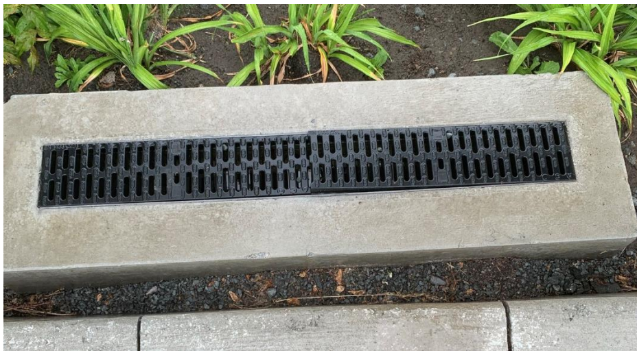
Figure 4.18 Espacement entre la bordure abaissée à l'entrée d'une cellule de biorétention et d'un bassin de stockage des sédiments
