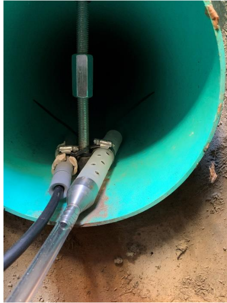
Figure 3.25 Vue de la crépine (à droite) et de la sonde de pression de l'échantillonneur automatique (à gauche) à l'intérieur du regard RP2-B
