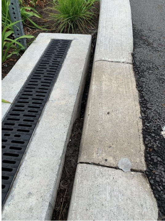
Figure 3.8 Abaissement de la bordure et bassin de stockage des sédiments à l'entrée des cellules de biorétention
