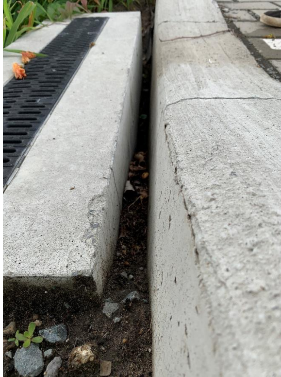
Figure 4.20 Creusement du terreau à l'entrée d'une cellule de biorétention par les eaux de ruissellement
