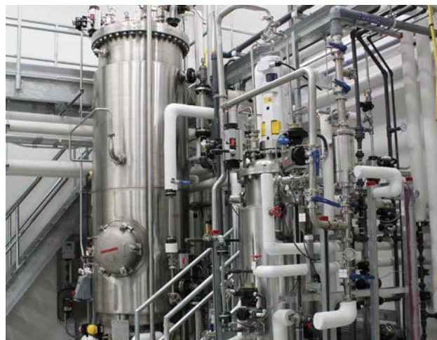
Hydrolyseurs de 150 et de 2000 litres
