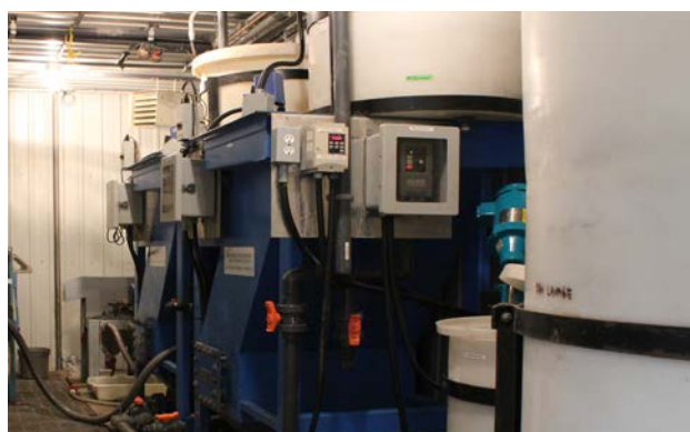
Décanteurs lamellaires avec instrumentation
